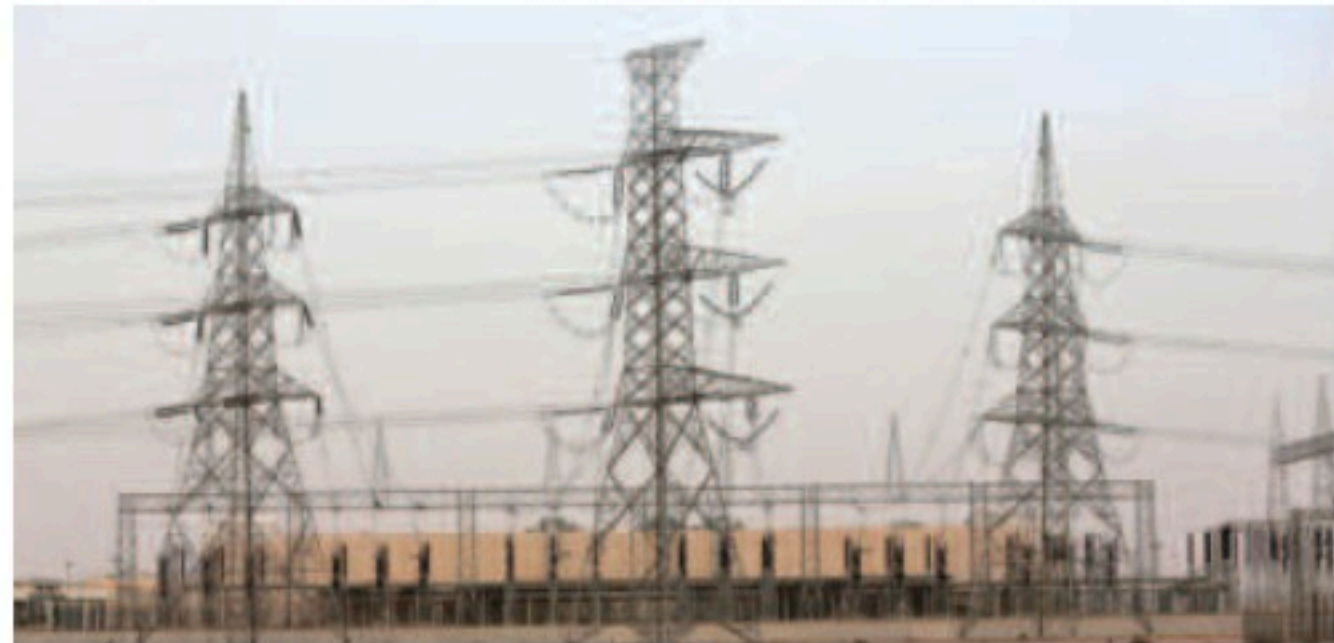
محطة سدير لتحويل الكهرباء
