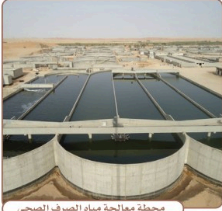
محطة معالجة مياه الصرف الصحي
